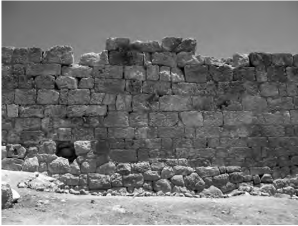
Fig. 2: Courtine 2-3, au niveau du sondage Frézouls 2. A partir du 2e bloc polygonal à droite de la cavité, on distingue une césure verticale dans l'élévation.
